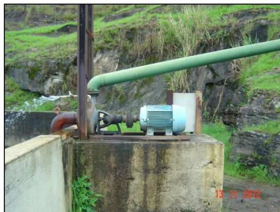
Figura 13 – Estação Elevatória de Água Bruta Nelson Carneiro
