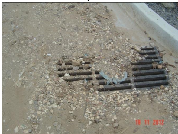
Figura 31 – Boca de lobo com problemas de limpeza
